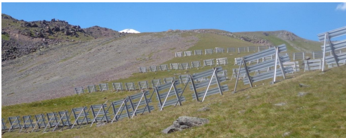
Рис. 22. Снегоудерживающие сооружения на склоне г. Эльбрус.
