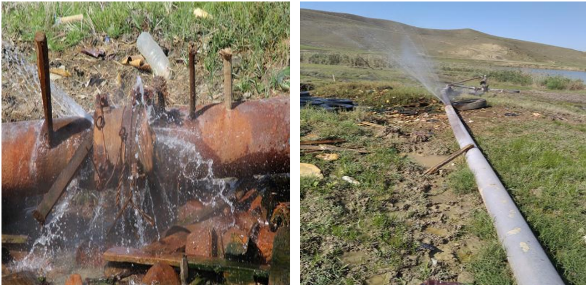
Рис. 3.25 Пробоины на трубопроводе (фото автора)
