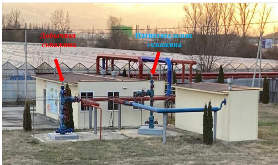
Рис. 1.5. Геотермальная станция (Ханкальское месторождение термальных вод) (фото автора)
