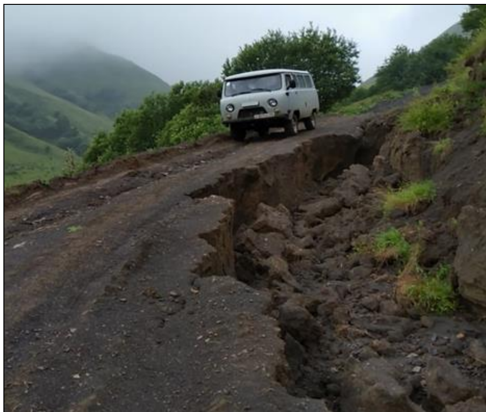
Рисунок 53. Дорожная эрозия по дороге Галанчо́ж – Акки
